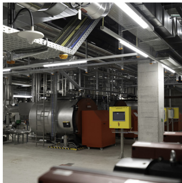
Hier sind die zwei Dampfkessel zu sehen und im Hintergrund der Heiznotkessel.
