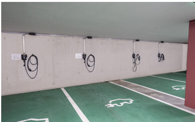
Die Ladestationen können bei Bedarf beliebig erweitert werden.
