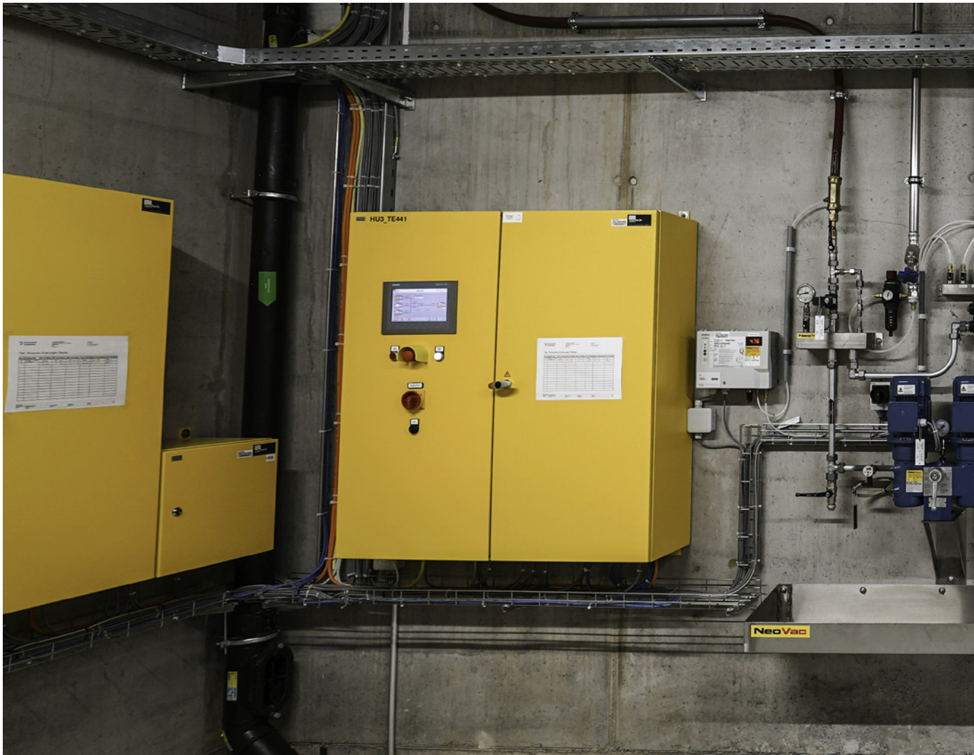
Die Brennstoffversorgungsanlage wurde redundant ausgelegt. Beide Systeme funktionieren autonom voneinander – fällt eine Anlage aus, wird automatisch auf die andere Anlage umgestellt.
