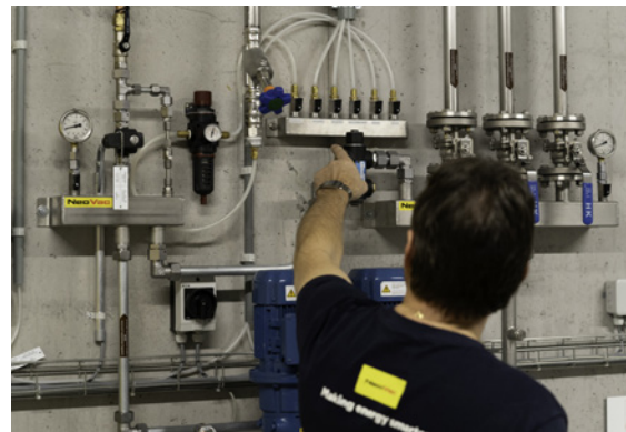
Dispositivi e attrezzature sono stati testati intensamente per due giorni.
