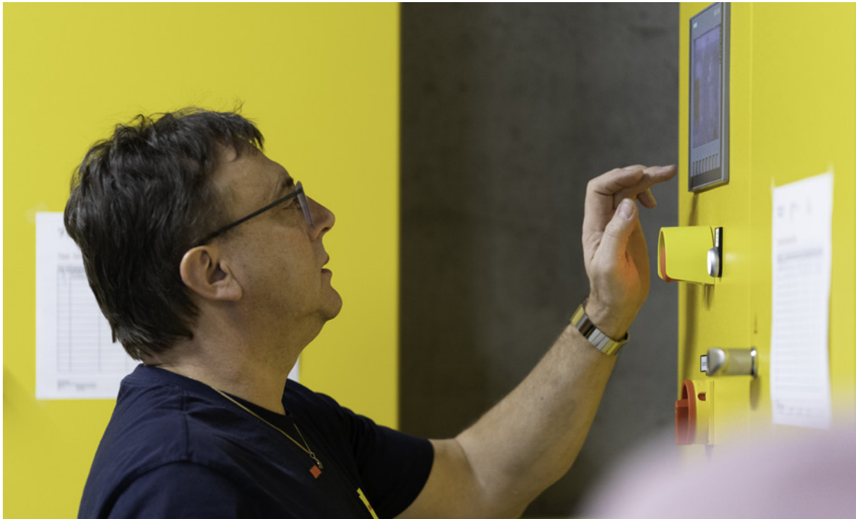
La catena di sicurezza funziona? Per scoprirlo, si attiva un allarme e si verifica ad esempio se le pompe si spengono correttamente.
