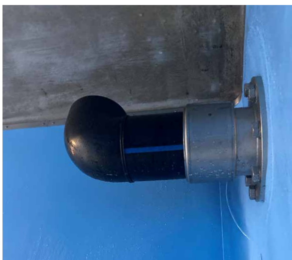
Trop-plein nouvellement installé avec joint de bride de serrage adapté pour assurer l'étanchéité du réservoir d'eau potable.
