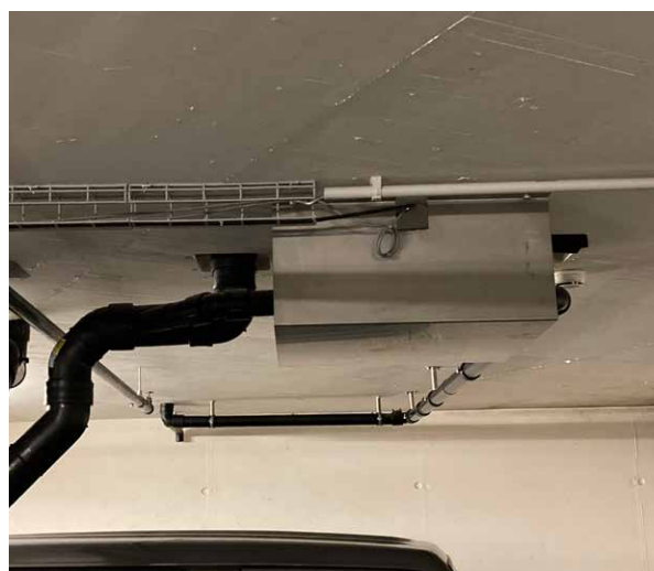
Dans le parking souterrain, on peut voir la conduite de vidange reliée à la conduite de décharge intermédiaire.
