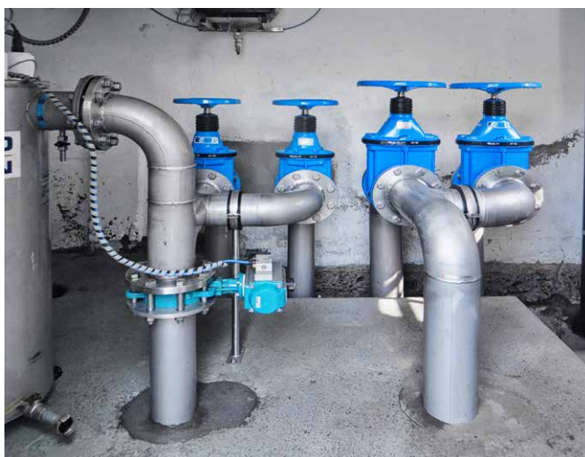
Condotte di erogatori a sorgente guidate tramite impianto UV
