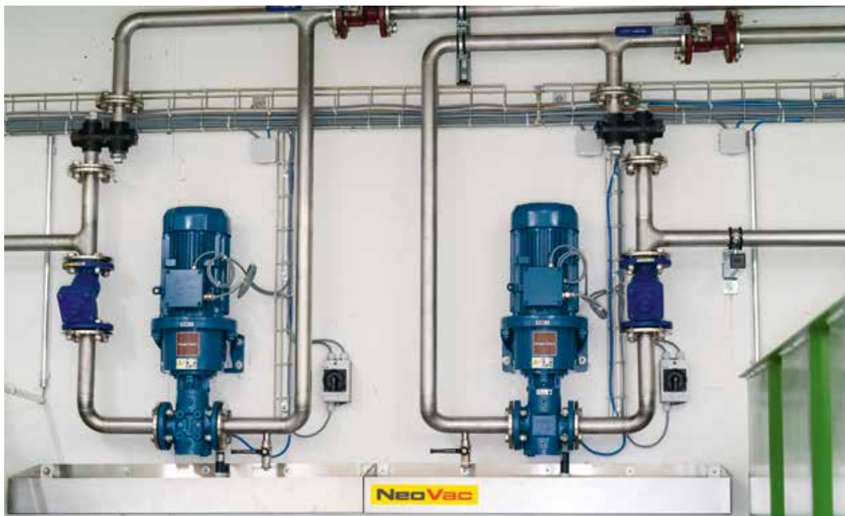
L'olio da taglio viene trasportato ai piani attraverso condutture di aspirazione e alimentazione.
