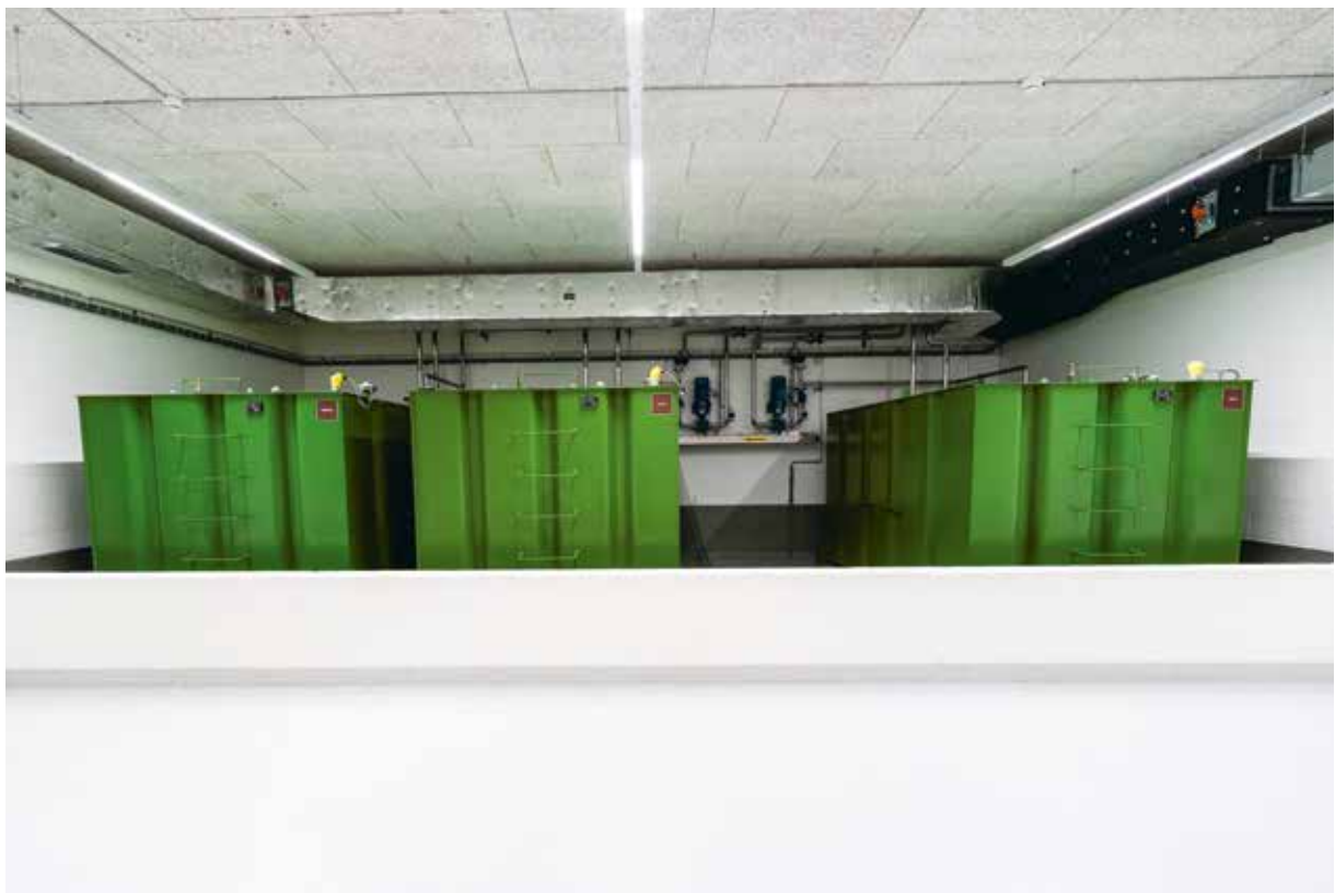
I due serbatoi per l'olio da taglio e il serbatoio per l'olio usato nel locale interrato hanno una capienza di 10'000 litri l'uno.
