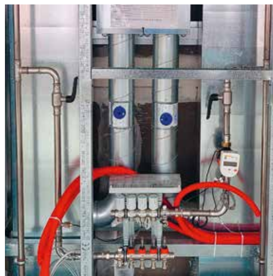
I moduli sono stati dotati di apparecchi di misurazione NeoVac.
