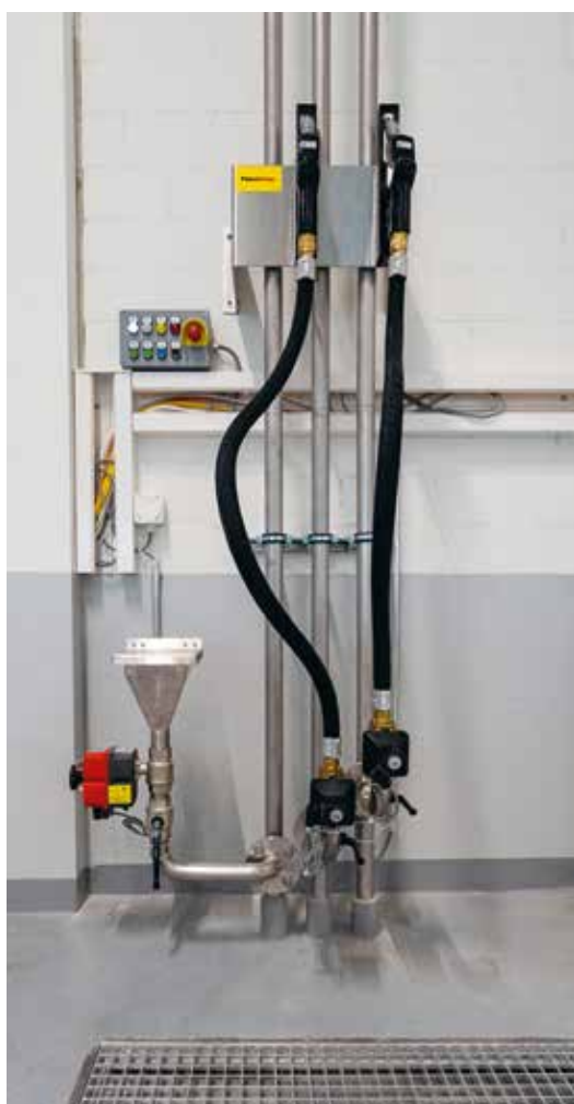
A ogni piano gli erogatori consentono di prelevare l'olio con facilità. Allo stesso tempo si può smaltire in sicurezza l'olio usato.
