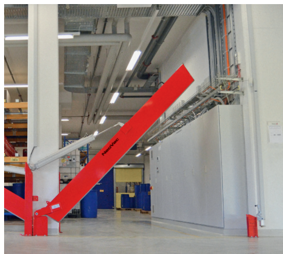
Barrières de retenue d'eau d'extinction d'incendie pneumatiques
