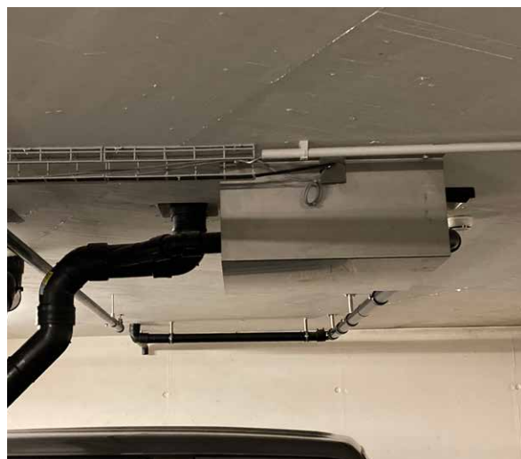
In der Tiefgarage ist die Entleerungsleitung mit der Zwischenraum-Entlastungsleitung zu sehen.
