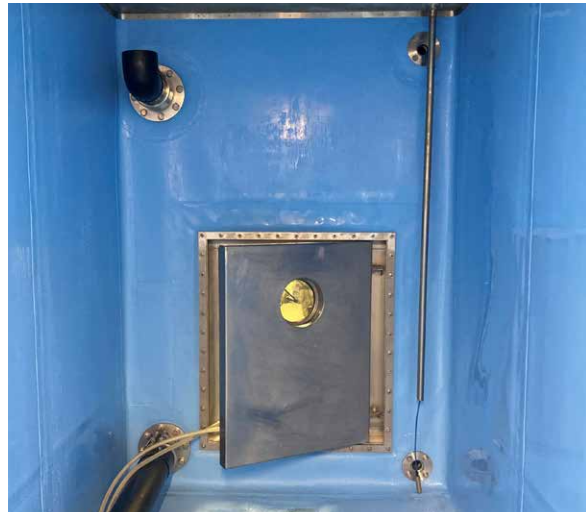
Blick auf den neu sanierten Einstieg des Wasserreservoirs: mit geschweisstem Klemmflansch und neuer Dichtung
